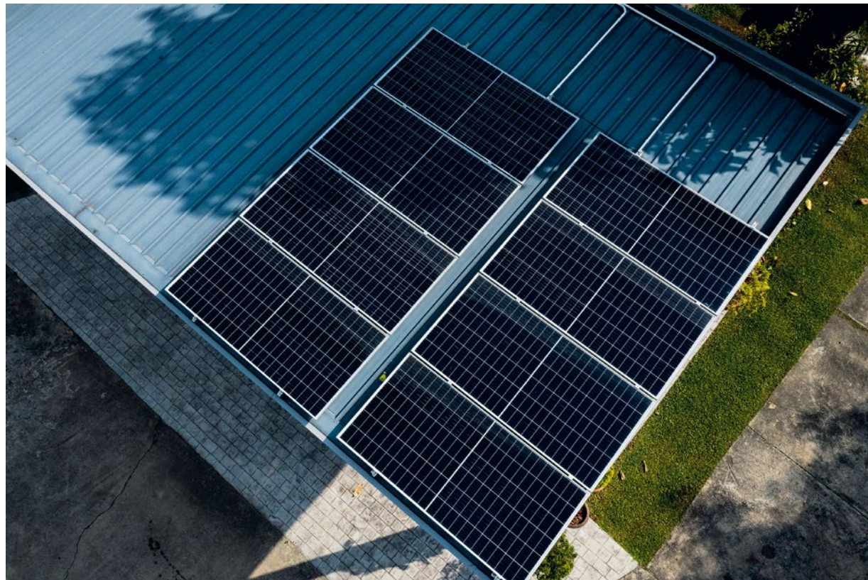
288 solárních panelů má první solární elektrárna ve Velkých Popovicích
